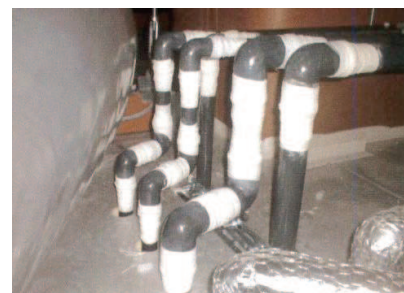
工場の新設薬品配管へ、継手部漏れ予防の為の補強現場
