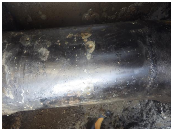
①腐食による、凹部分がある事を確認する
