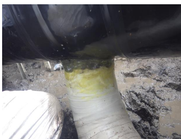
⑥分岐の部分も、⑤と同様の施工を行い、作業を終了する
