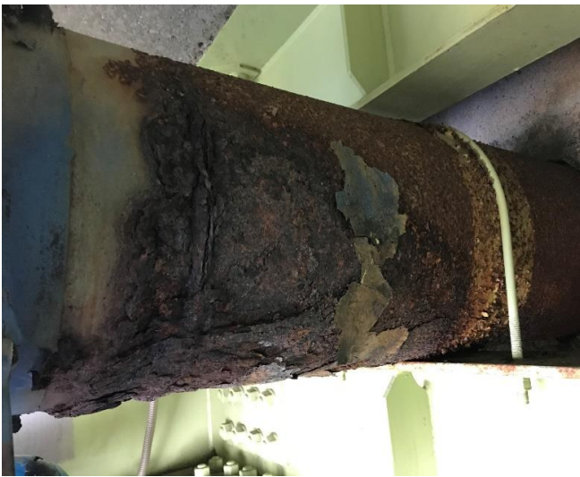
①施工前 錆が全体的に酷く、一部はウエハース状になっている状態。
