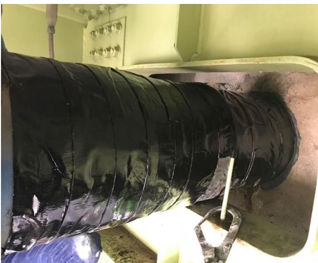
③次に、壁との接続部分を一周と金具が有ってブチルロールを貼れなかった部分に、補強と凹凸を埋める目的でオリスチール(金属粉入りエポキシパテ)を充填する。
