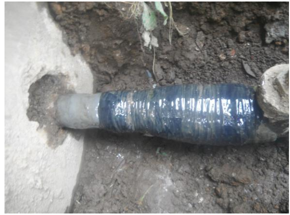
⑧続けて、防食、補強効果を高める目的で、オリシールを塗布する。
