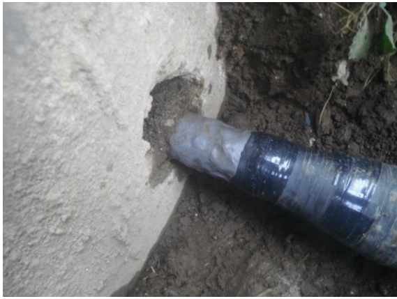
⑦オリステープを巻き終わり後、配管の露出部分を無くす目的で、オリスチールを充填する。
