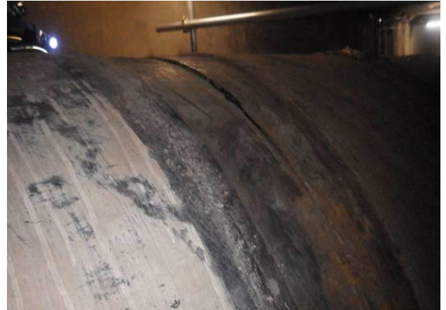
②施工箇所の状況を確認させて頂く。エルボ部から数十cm程、斜め横に落ちた所あたりに傷口を確認する。
