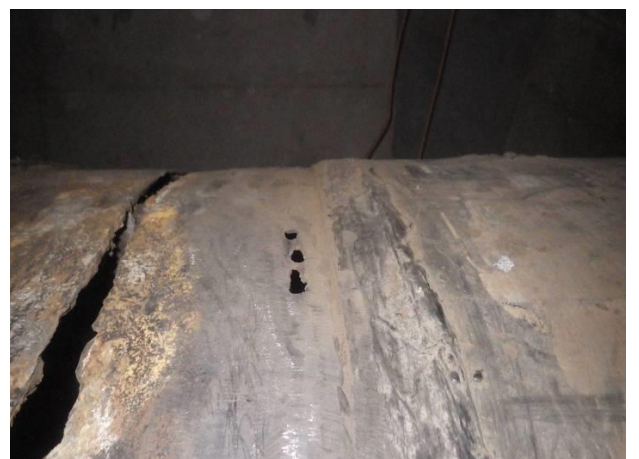
④亀裂部分の横、約10cm位の所に、10mm強の穴を3箇所確認する。
