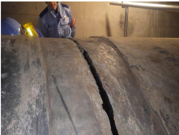
③円周の約1/3（長2200mm）に幅20mmの亀裂、破損を確認する。
