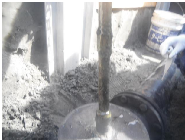
④他箇所補強 仮止めが出来ている事を確認後、オリシール(液体エポキシレジン)を直管部分に塗布する。
