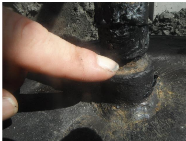
②傷口部確認 数mmのヒビが有り、そこからガスが噴出している状況。
