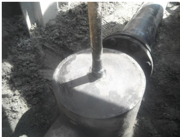
①施工前 漏洩部分を確認。接続されているソケットの辺りから漏れている。
