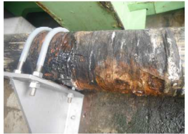
④他箇所の腐食部分を確認。
