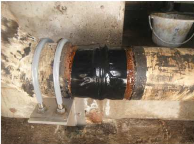
③周辺も、管肌が露出している部分は、防食の為プチルロールで覆う。
