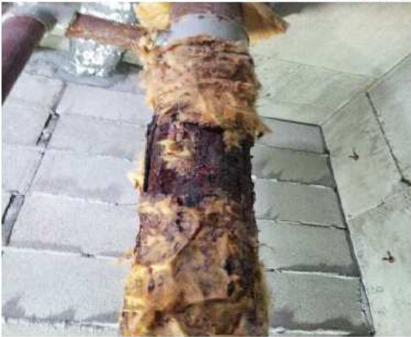
①予め保温材を外して頂く。 錆が酷くウエハース状になっている為 ケレンは慎重に状況を見ながら行う。
