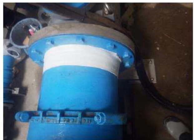
⑥マホータイの硬化は約30~40分掛かるが、漏水はマホータイの段階で止水が出来ている為マホータイの完全硬化を待たず、全ての作業を終了する。
