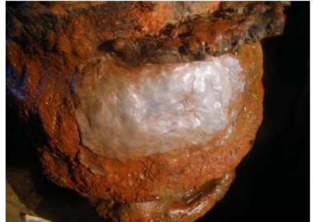
④続けて、傷口に当てがいがながら、もう半面にもオリスチールで挟み込むように貼り付け、傷口を完全に覆う。 (もう1箇所も同様に施工する。)
