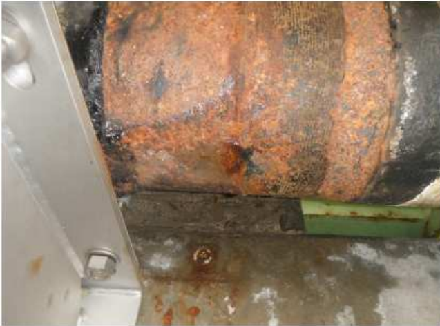
①漏水箇所の確認をする。
