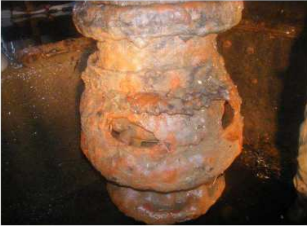
①現場の状況を確認する。 約10cm四方と約15cm四方の穴を2箇所確認する。
